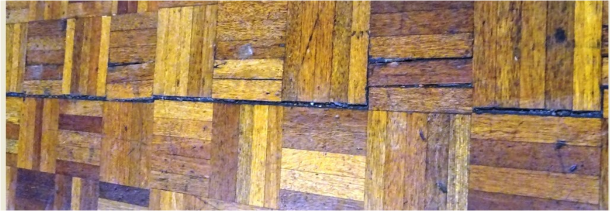
Foto 2: Versleten parketvloer in de grote zaal.
