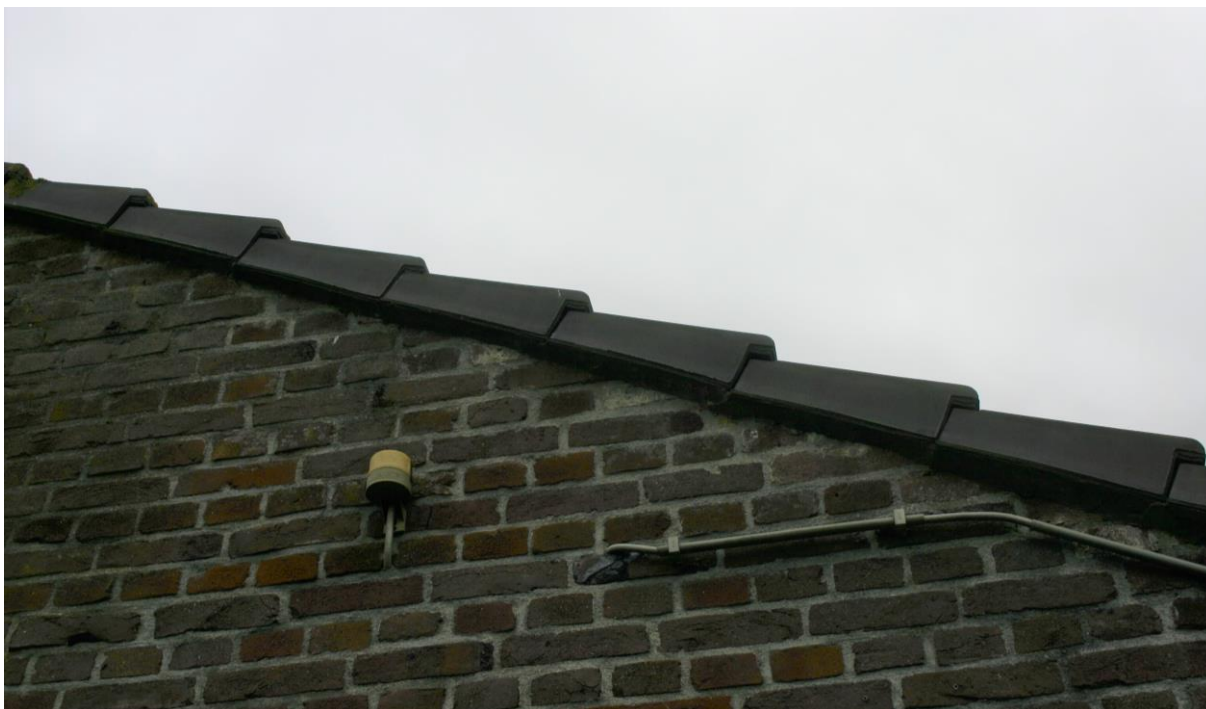
Figuur 4.4. De gevelpannen van de woonboerderij zijn afgestreken met specie en de woning heeft geen spouw. Hier is dus geen plek voor soorten als gierzwaluw en vleermuizen om in te vliegen.
